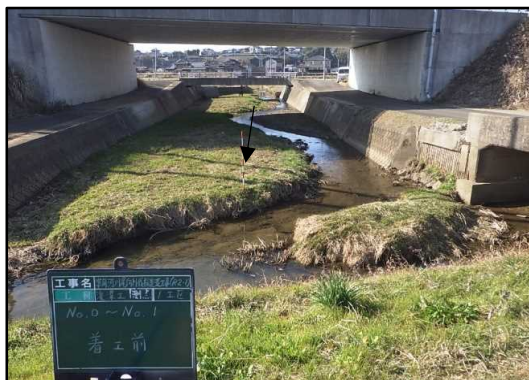
土砂が堆積した河川
