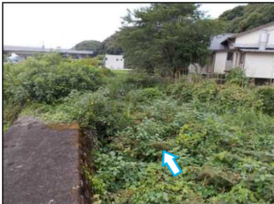
雑草が繁茂し土砂が堆積した河川
