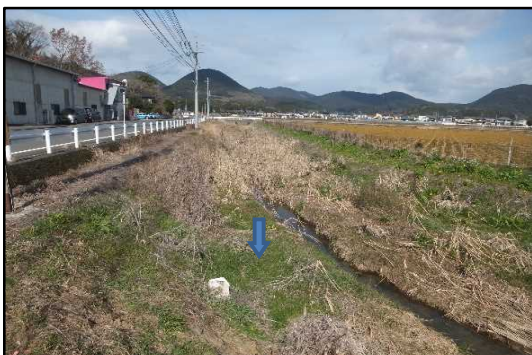
土砂が堆積した河川
