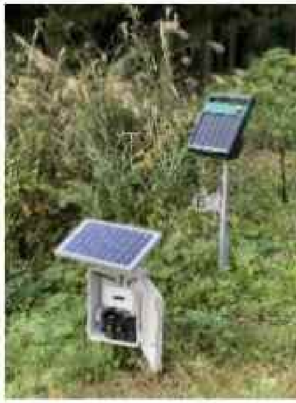
電気柵監視システム (親機、子機)
