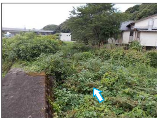
雑草が繁茂し土砂が堆積した河川
