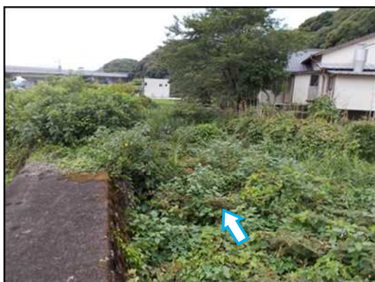
雑草が繁茂し土砂が堆積した河川
