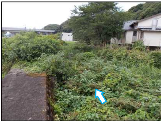
雑草が繁茂し土砂が堆積した河川
