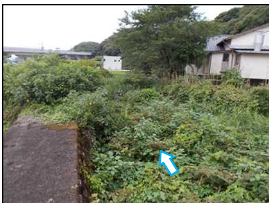
雑草が繁茂し土砂が堆積した河川
