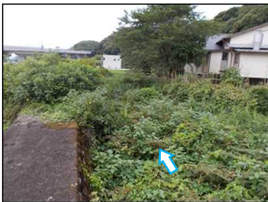
雑草が繁茂し土砂が堆積した河川
